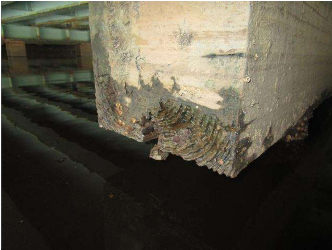
Bent 2 Cap 2: SUBCAP AT PILE 4, 3IN X 3IN X 3IN DEEP DECAY, PAR
