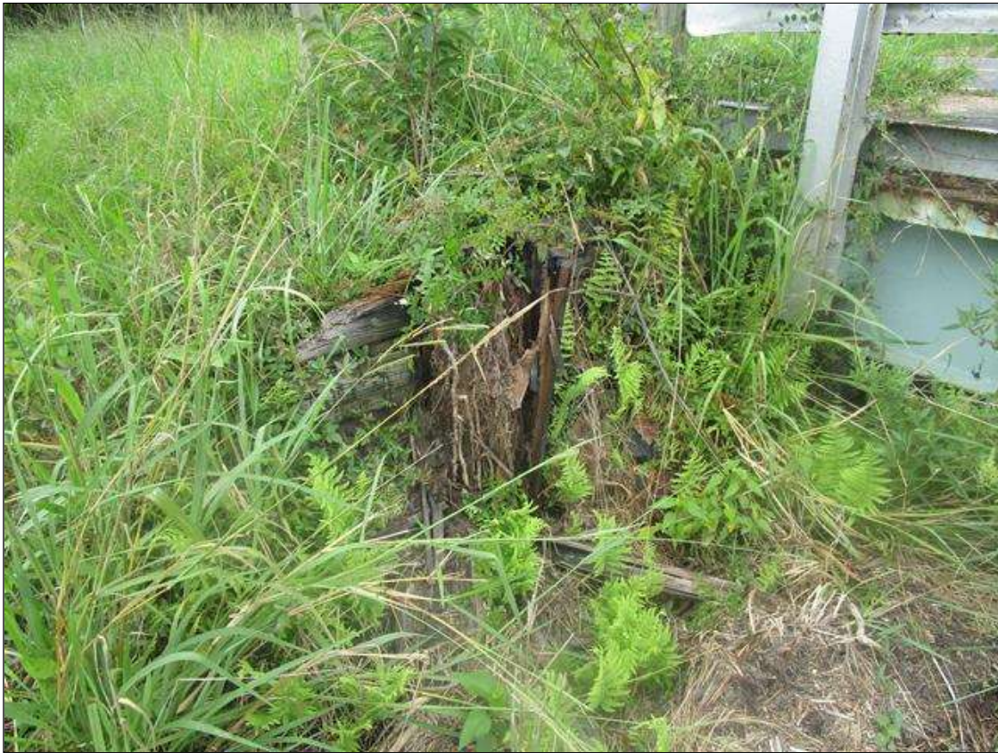
END BENT 1 RIGHT SIDE, 100% DECAY IN ABUTMENT PILE, PAR
