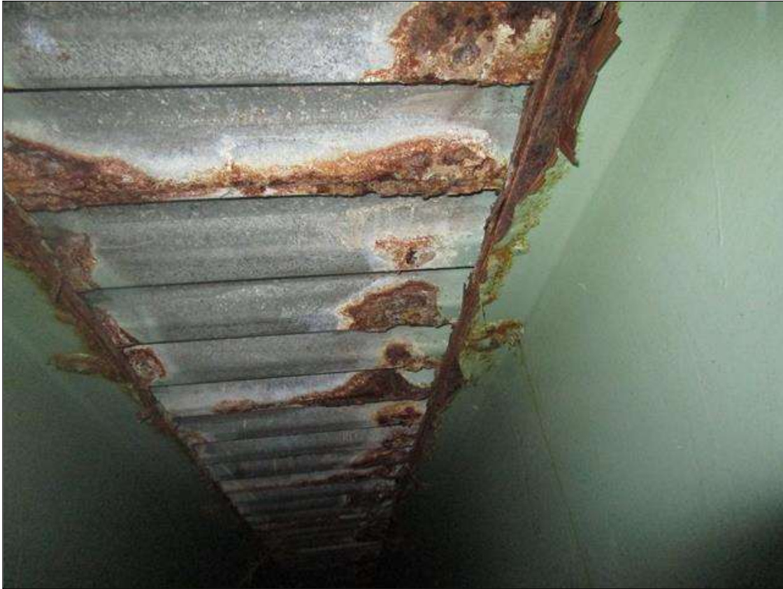
Span 2 Deck: BAYS 5-6, 20SF OF 25% SECTION LOSS, PAR
